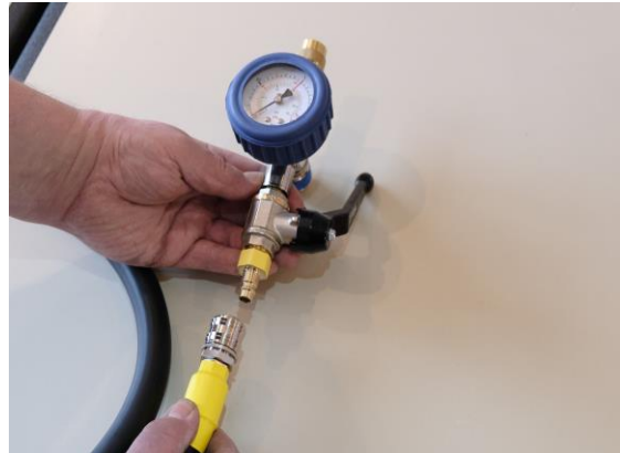
2. Kuppeln Sie den Vordruckschlauch an den Stecknippel (gelb) der Sicherheitsarmatur und verriegeln Sie die Verbindung. Beachten Sie, dass der Kugelhahn quer zur Fließrichtung steht
